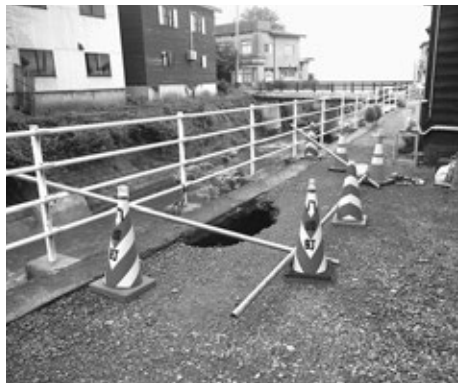
河川脇の被害箇所
