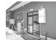
施工例(灯油ボイラーからの変更)
