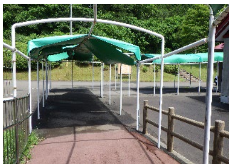
[自由通路の屋根のはがれ]
