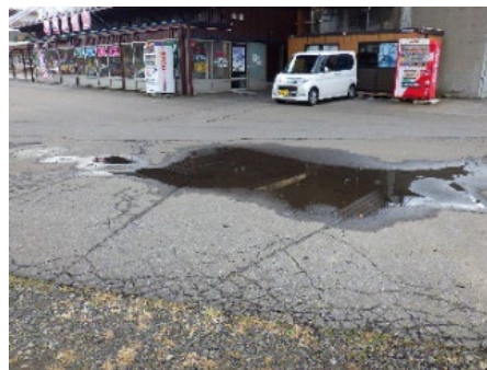
[駐車場の水たまり]
