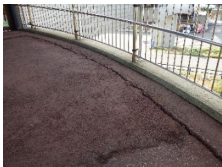
[スロープの地盤沈下]
