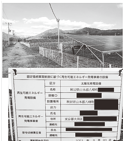
本館地区の太陽光発電設備
