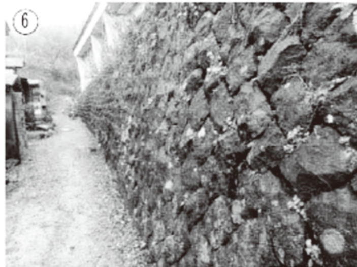
「はらみ出し」が指摘された擁壁
