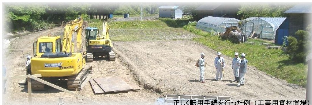
正しく転用手続を行った例（工所用資材置場）
